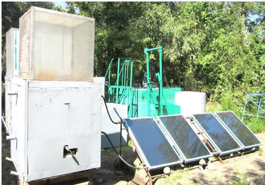
Рисунок 1 - Общий вид гелиобиогазовой установки
